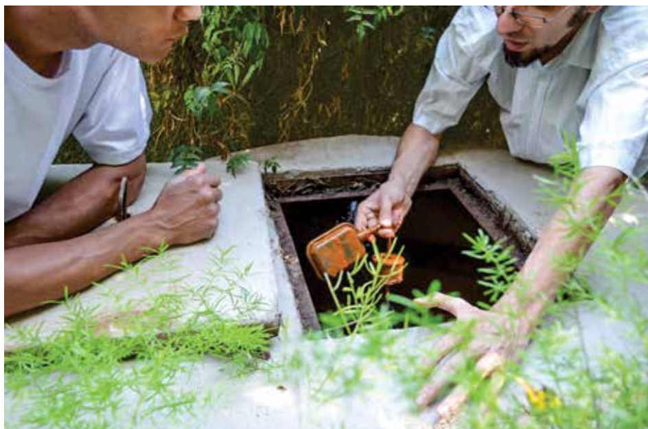
Figura 7 – Cisterna 3 - Nível de água é controlado com boia elétrica (C)
