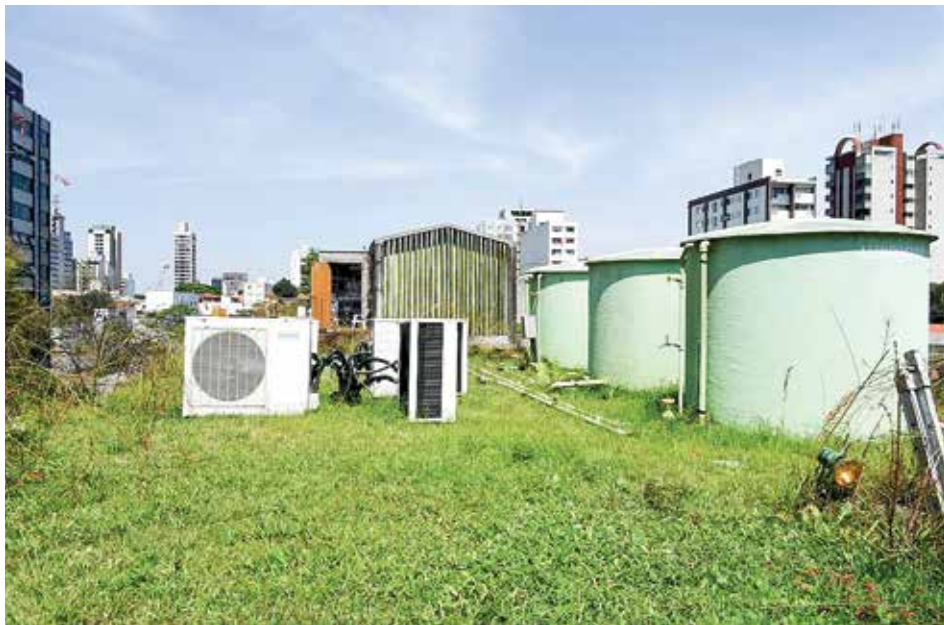
Figura 5 – Caixas elevadas posicionadas na laje distribuem água por todo o sistema
