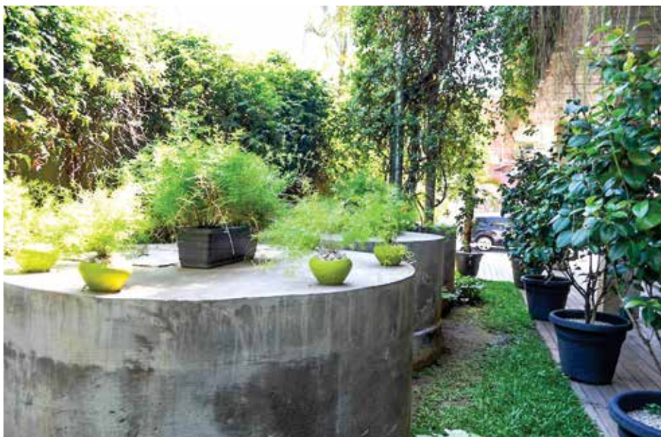
Figura 4 – Cisternas feitas em anéis de concreto no pavimento térreo armazenam a água captada na chuva e no telhado verde para reaproveitamento no sistema
