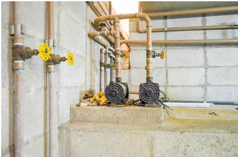
Figura 8 – Sistema de bombeamento conduz água do reservatório subterrâneo para as caixas elevadas (E)
